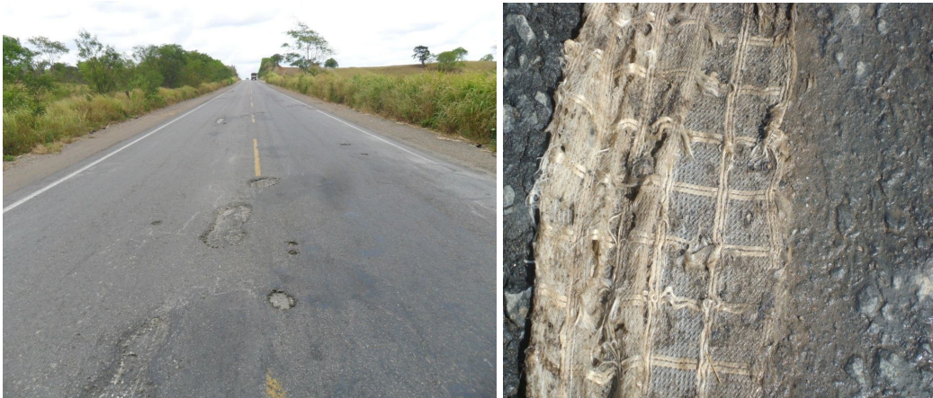
Figura 10 - Caso de uma má impregnação do geocomposto.
