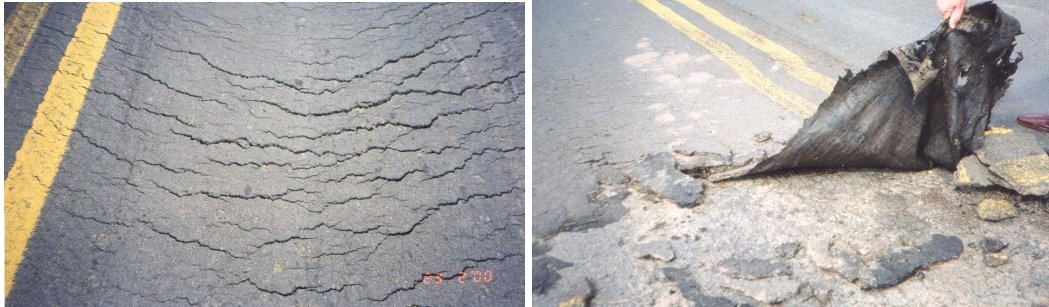
Figura 9 - Caso de uma má impregnação do geotêxtil.
