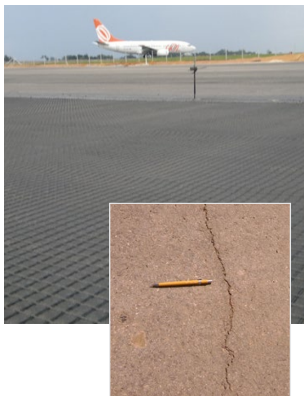
Figura 1 – Trincamento por retração da base cimentada.
