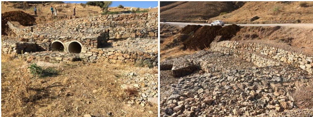
Figure 1. Vues de l'instabilité
