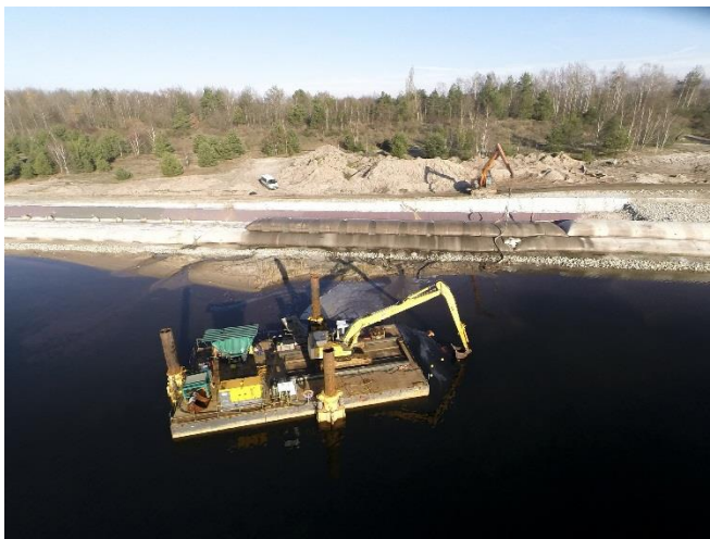
Abb. 10: Das im Vordergrund liegende Installationsponton während der Befüllung der zweiten geotextilen Schlauchlage im Hintergrund
